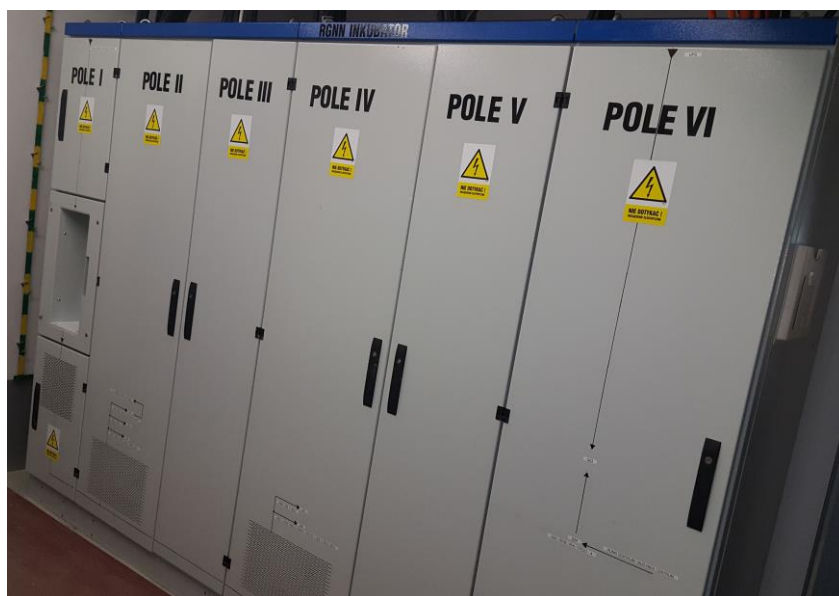
Rysunek nr 13: rozdzielnica nn w budnku Inkubatora Technologicznego i Administracji,
